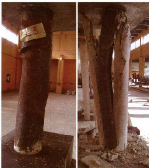
Figure 19 : Mode de ruine des poteaux mixtes acier-béton [19].
